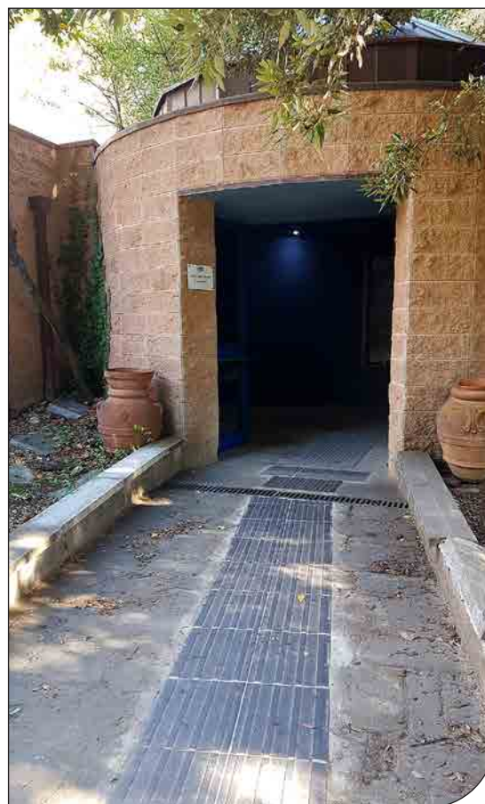
Fig. 4. Accesso alla Sala del Mare, demolizione di pavimentazione per inserimento di pavimentazione tattile in perfido.
