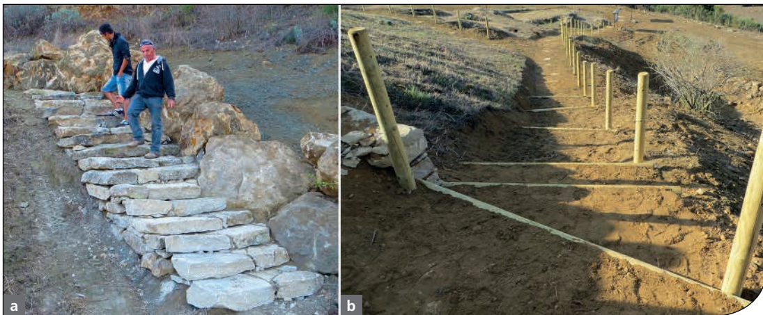
Fig. 5. a) Fase di pavimentazione di un sentiero costituito da lastre di arenaria; b) palizzate in legno per delimitare i percorsi.
